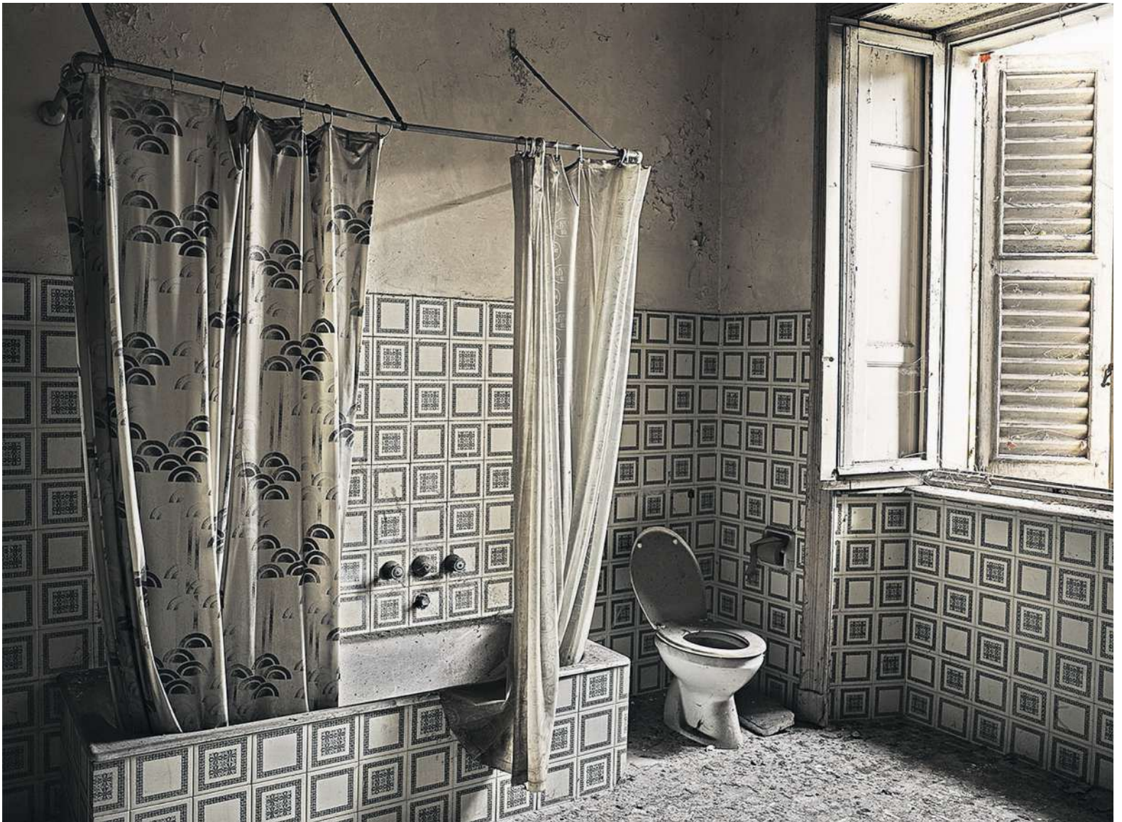
Die Missachtung traf das Gebäude abrupt. Duschvorhang, ja gar das Toilettenpapier, alles noch da.
